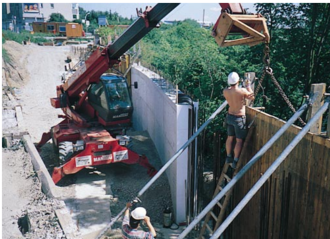
Abb. 3: Teleskopmaschine mit drehbarem Oberwagen und Kranausleger beim Schalungstransport und -einbau auf weiträumiger Brückenbaustelle
