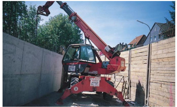
Abb. 11: Quetschgefahr durch den drehbaren Oberwagen bei benegter Einsatzstelle
